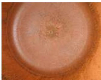
Korodirana notranjost rezervoarja
